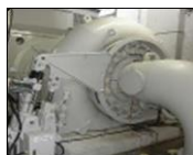
水力用発電機
