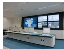
総合監視システム
