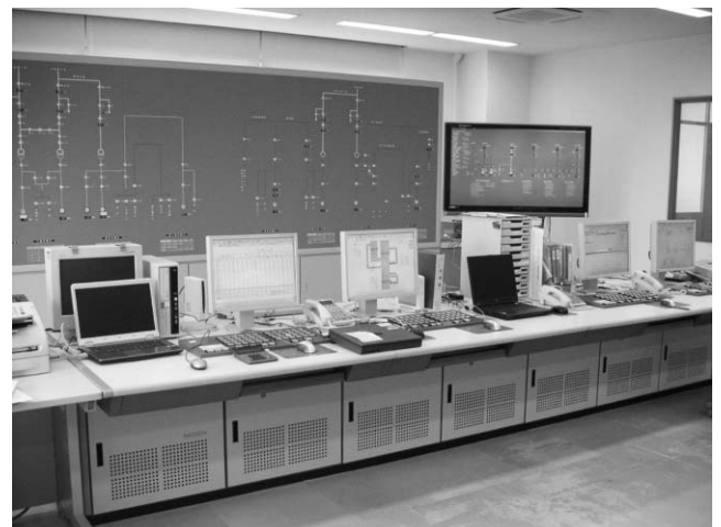
第11図 監視制御装置
