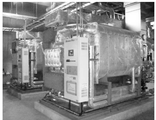
第6図 排熱投入形冷温水発生器設備
