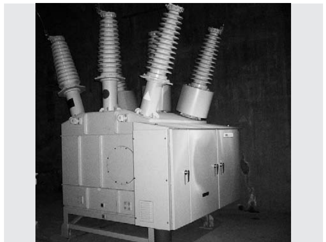
第2図 72kV VFS
