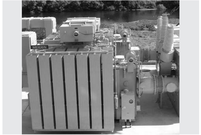
第1図 66kV C-GIS及び特高変圧器
