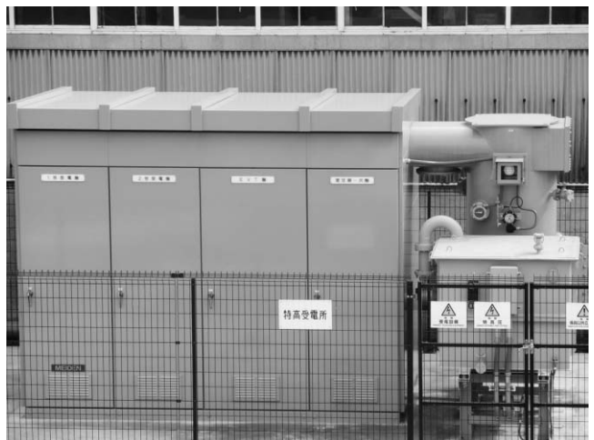
第3図 66kV C-GIS及び特高変圧器
