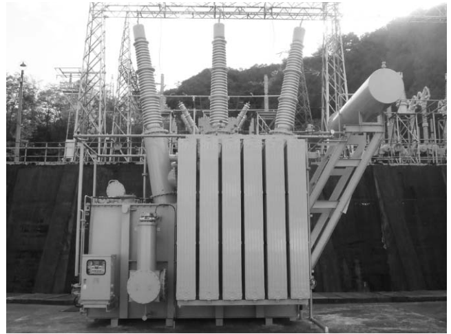
第7図 154kV 25MVA 変圧器
