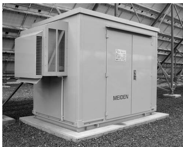
第2図 PV用PCS PV用PCSは、屋外耐塩仕様の密閉形パッケージに収納して設置している。
