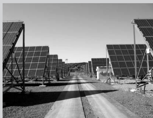
太陽光発電実証研究稚内発電所
