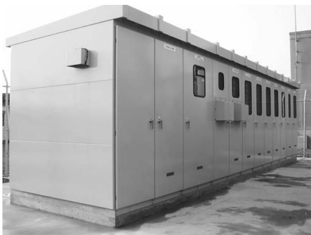
第4図 特高変電所
