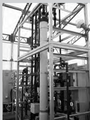
浄水処理システム
