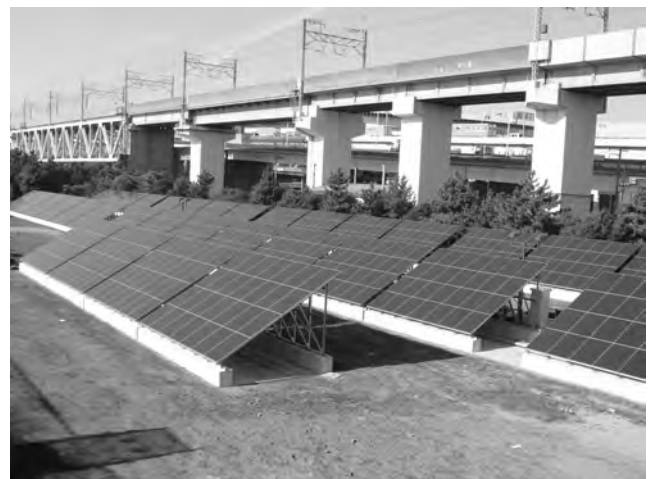
第2図 太陽光発電設備(「固定」タイプ)
