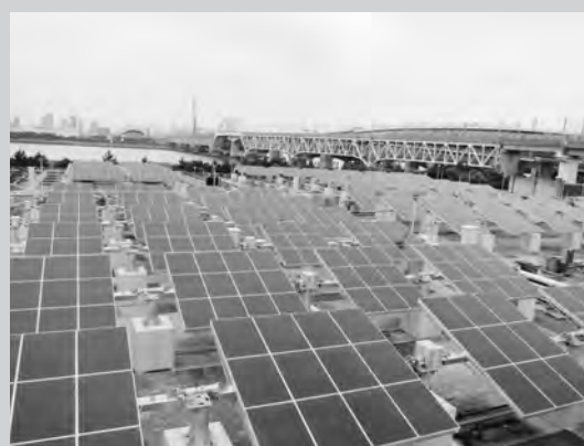
葛西水再生センター太陽光発電設備
