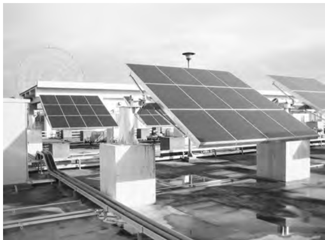
第3図 太陽光発電設備（「一軸追尾」タイプ） 「一軸追尾」タイプは、1アレイ当り21枚（7直列×3並列）で構成され、処理施設上部に設置されている。
