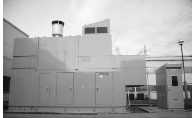
第4図 500kW常用非常用兼用発電設備
