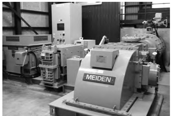
第8図 クロスフロー水車発電装置
