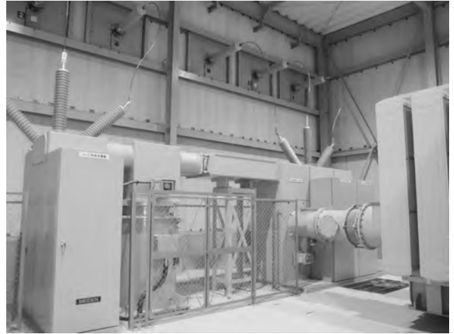
第13図 84kV C-GIS及び77kVガス絶縁TR
