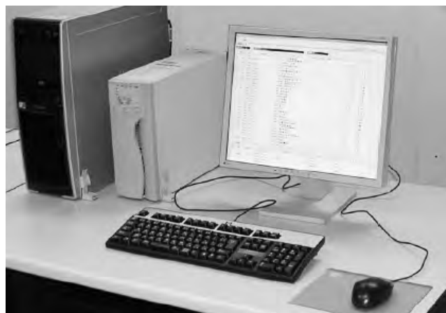
第6図 中央監視装置
