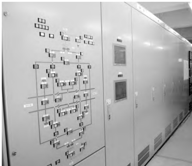
第14図 新玉東SS監視制御盤
