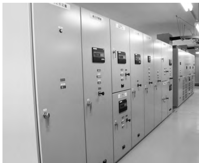
第16図 新大牟田DP高压配電盤 新大牟田DPの高压配電盤外観を示す。気中絶縁方式で気中自冷式とし、コスト削減を図った。
