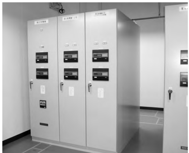
第17図 金浜DP乾燥空気絶縁開閉装置 金浜DPの高压配電盤外観を示す。乾燥空気絶縁方式で、周囲環境に影響が少なく、メンテナンスが容易である。
