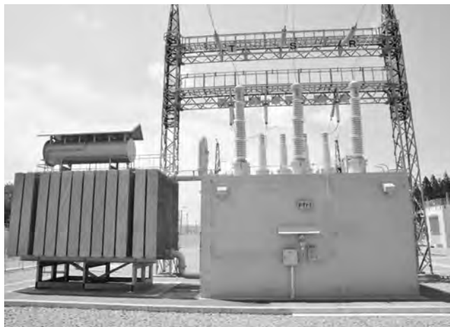
第6図 50MVAスコット変圧器 50MVAスコット変圧器の外観を示す。一次側154kV・二次側60kV×2回線となっている。
