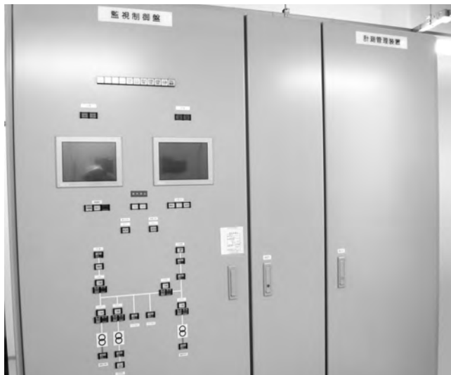
第19図 新大牟田DP監視制御盤
