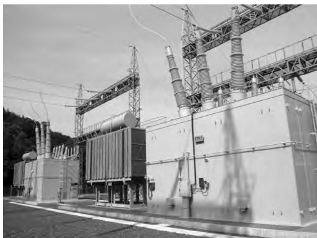
第7図 70MVAルーフ・デルタ変圧器 70MVAルーフ・デルタ変圧器の外観を示す。一次側220kV・二次側60kV×2回線となっている。
