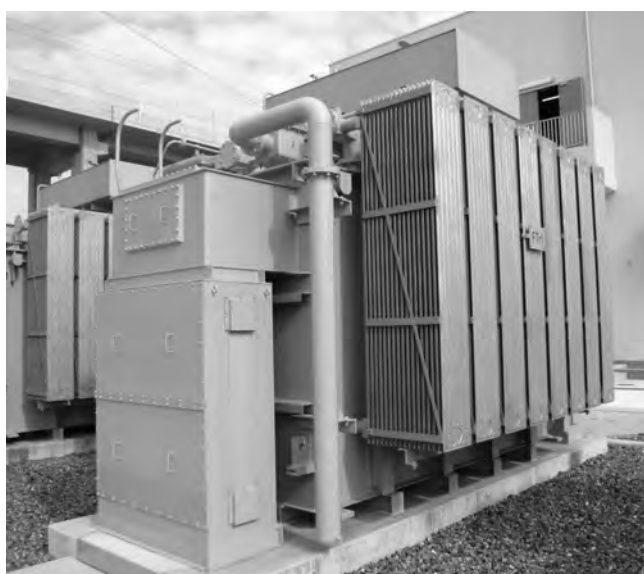
第8図 20MVA不等辺スコット変圧器 20MVA不等辺スコット変圧器の外観を示す。一次側66kV・二次側30kVとなっている。
