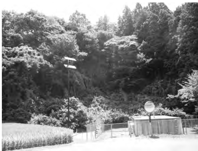
第5図 太陽光TELEMOT通信実証実験設備
