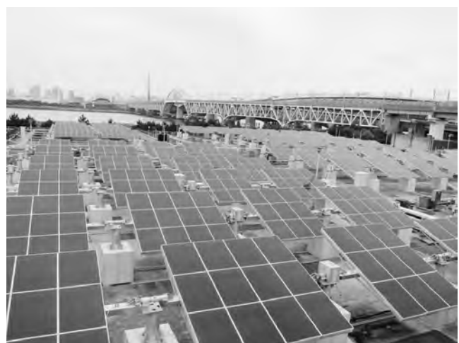
第10図 一軸追尾タイプ太陽光発電設備
