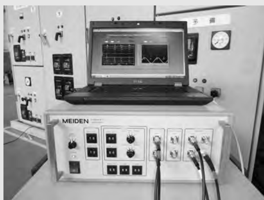
(b) 電磁波検出法部分放電測定装置
