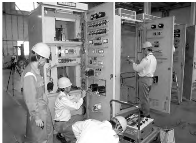
第4図 高圧受変電設備点検訓練 お客様設備と同等の高圧受変電設備で点検訓練を実施する。
