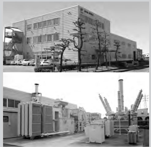
技術センター外観(上)と特高機器実習場(下)
