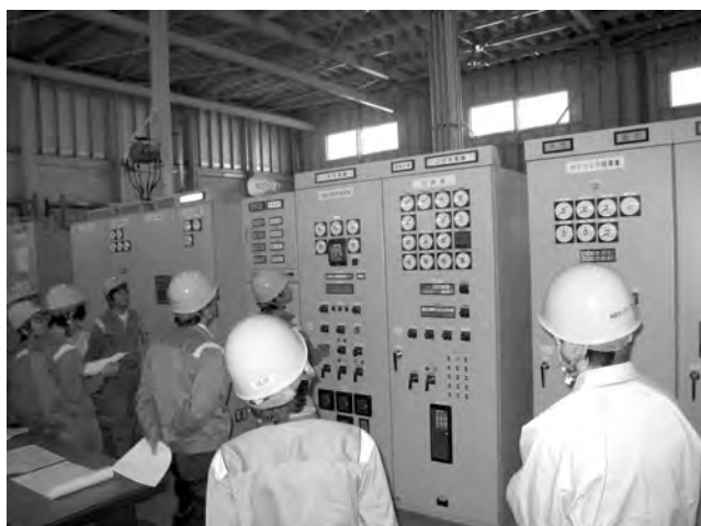
第13図 発電設備（自動始動発電機盤）教育 自動始動発電機盤の機能及び起動/停止操作を学ぶ。
