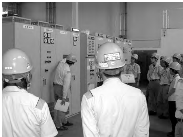
第12図 電力変換装置教育 UPSの機能及び運転/停止操作を学ぶ。
