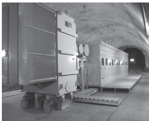
三岳 SSP 新設機器全景
