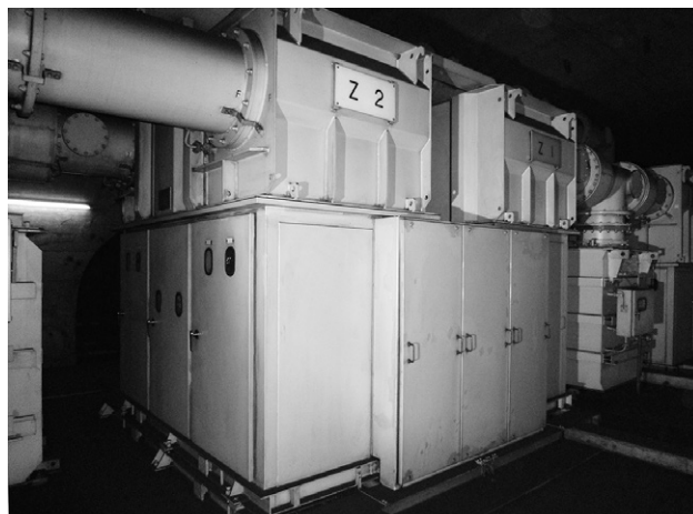
第4図 既設C-GIS（ユニット間管路接続形）
