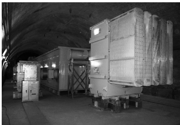
第3図 新設AT（右手前）及びOT・OT二次盤（左奥）
