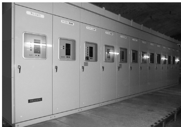
第5図 新設C-GIS（配電盤形）
