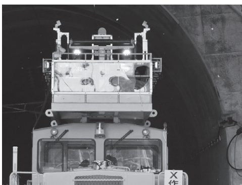
新線向け架線検測装置
