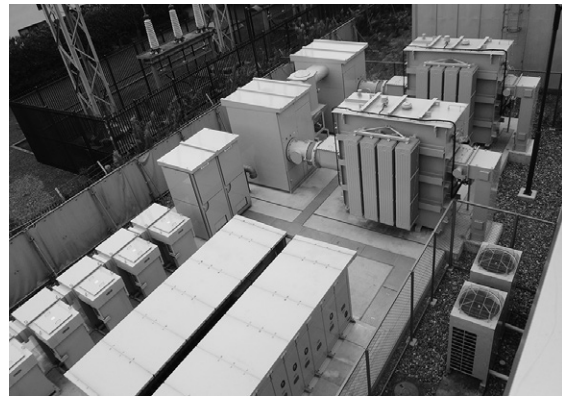
第8図 特高受変電設備
