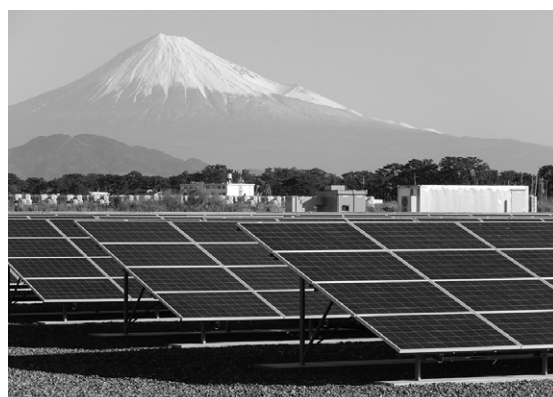
第23図 メガソーラーしみず電気設備
