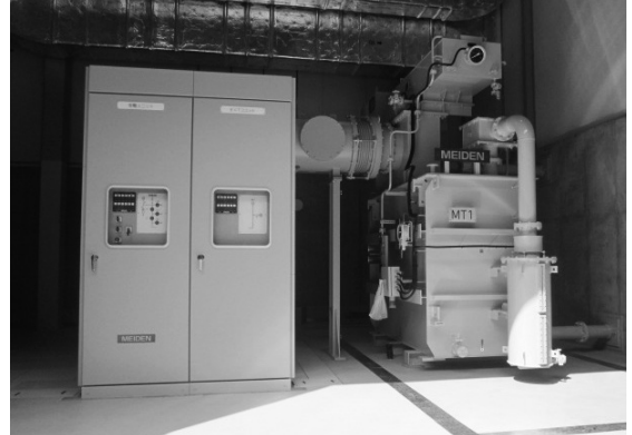
第1図 パームヤシ油入変圧器
