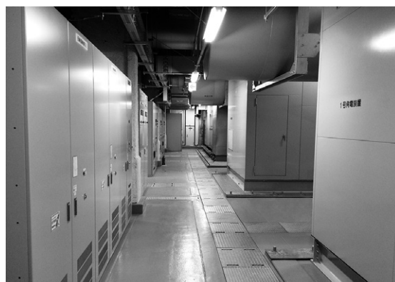
第18図 非常用発電設備
