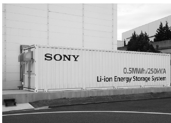
第27図 交直変換装置（250kVA）
