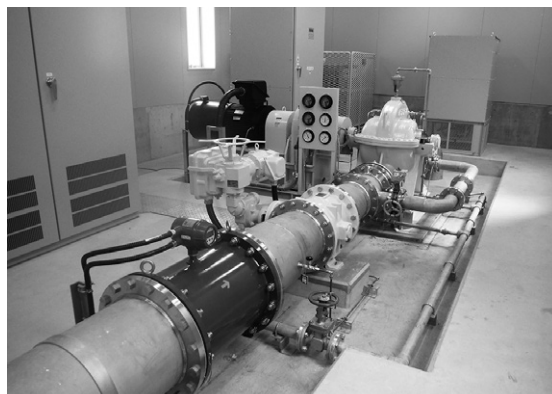
第21図 水力発電設備
