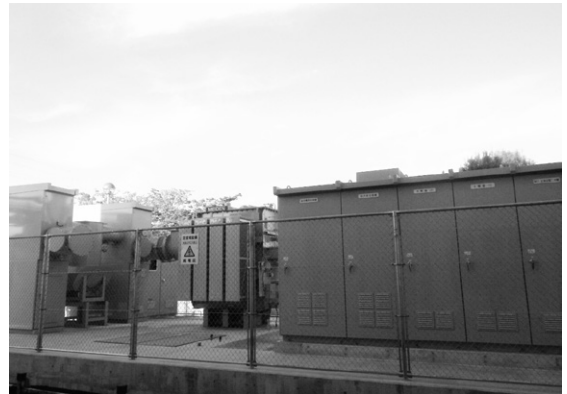
第7図 特高受変電設備
