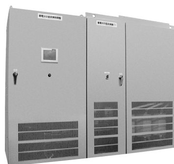
第26図 鉛蓄電池用交直変換装置
