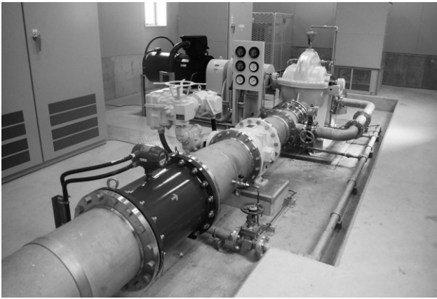
(a) 水車発電機全景
