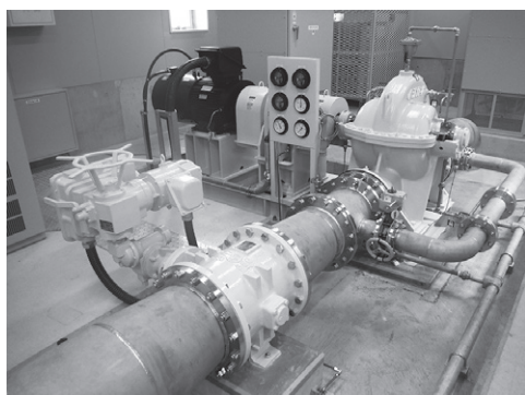
水車発電機設備
