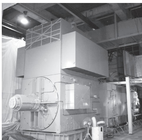
25,000kVA 発電機（ガスタービン）
