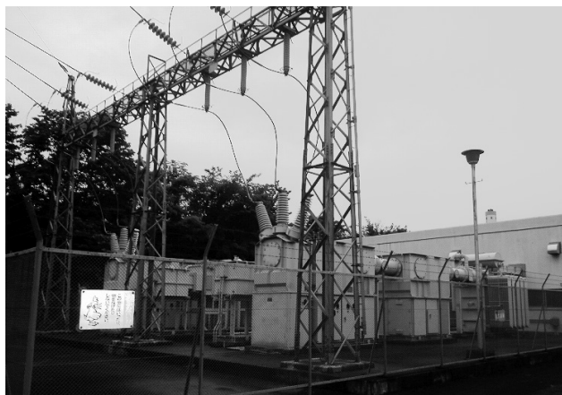
第 1 図 既設V-sub
