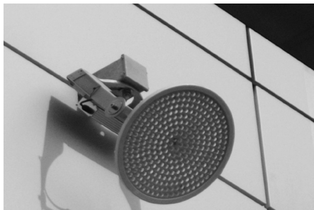
第5図 駐車場のLED照明
