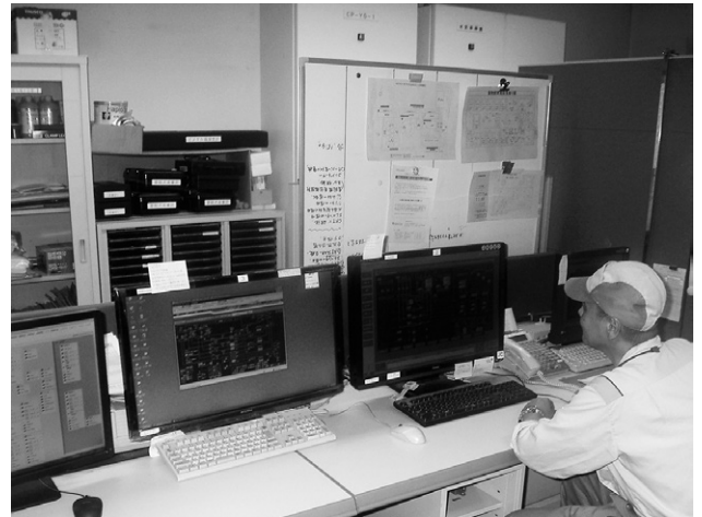
第8図 運転監視状況
