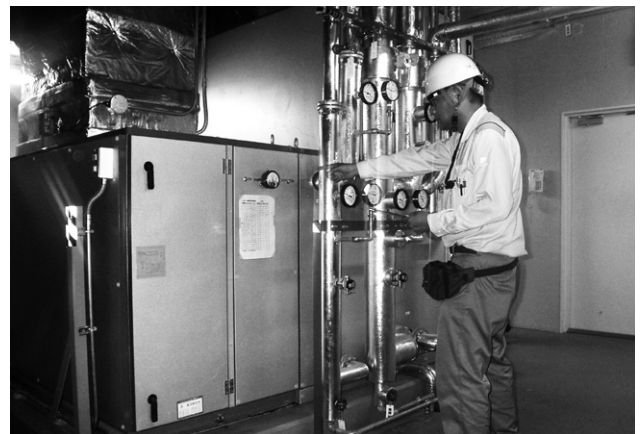
(a) 空調設備の日常点検
