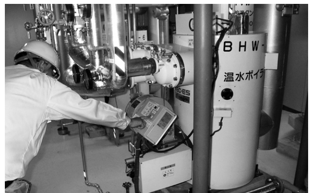
(b) 熱源設備の日常点検
