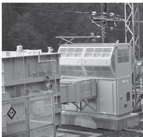
JR西日本(株)上石見変電所 整流器設置例
