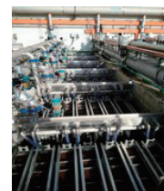
チェスナツアベニュー浄水場の膜ろ過設備
