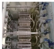
チャンギ水再生プラントの膜ろ過設備
