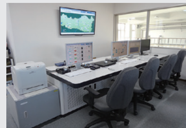
中央監視装置
