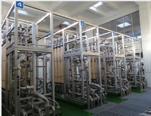
デザインビルド膜ろ過浄水場（膜ろ過室）
