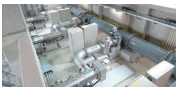
紫外線照射装置 (16,000m 3 /日×3基)
