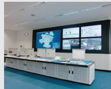
監視制御システム
