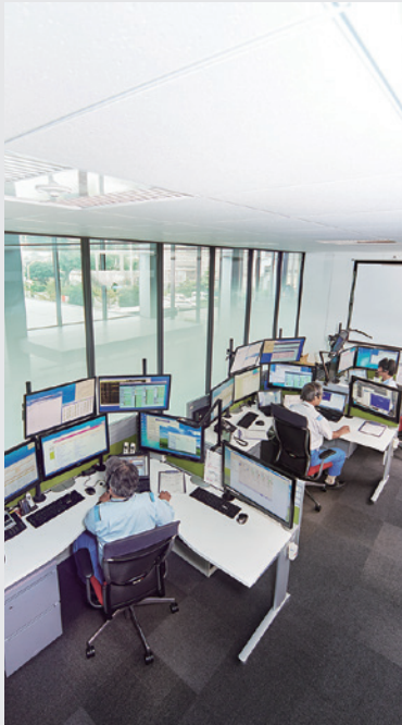
オペレーションルーム
