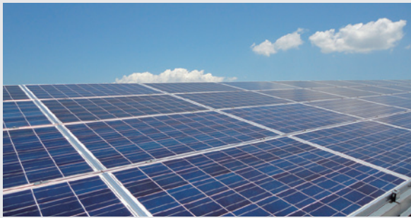
太陽光パネル
