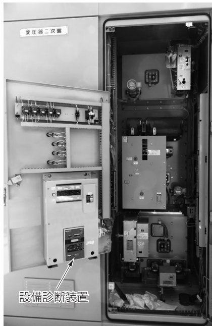
第1図 C-GIS内部に搭載された設備診断装置
