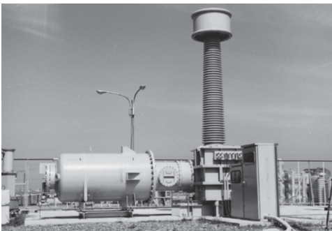
日本初の500kV系統用GIS用避雷器の課電試験風景
