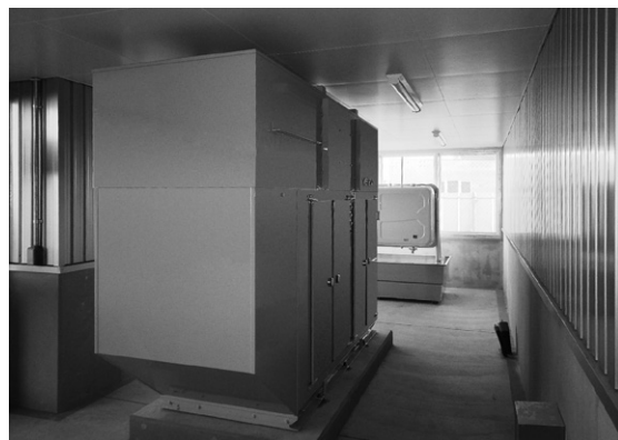
第8図 50kVA非常用ディーゼル発電装置
