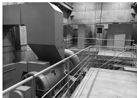
第15図 水力発電設備
