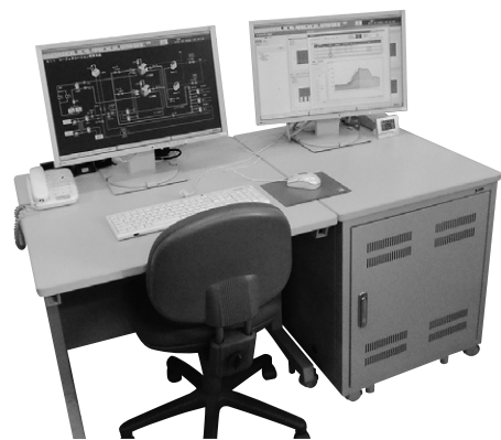
第 6 図 監視制御操作卓
