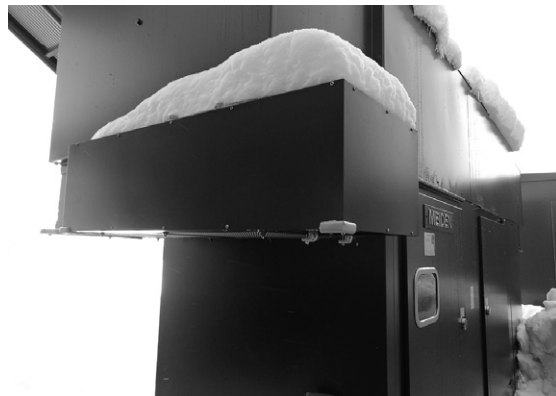
第7図 200kVAディーゼル発電装置
