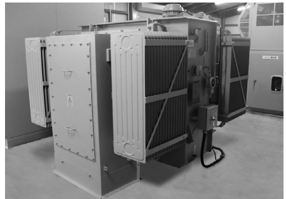
第4図 新設した整流器用変圧器
