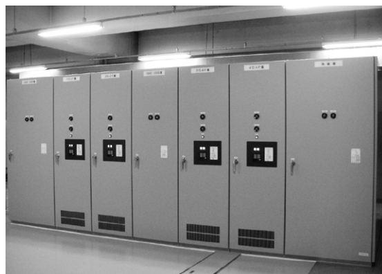
第3図 直流き電設備
