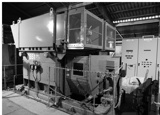
第1図 仕上1号ミル駆動用巻線形誘導電動機
