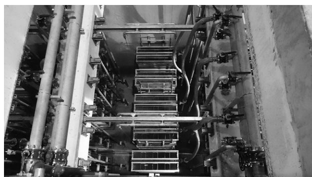
第5図 チャンギ水再生センター MBR設備
