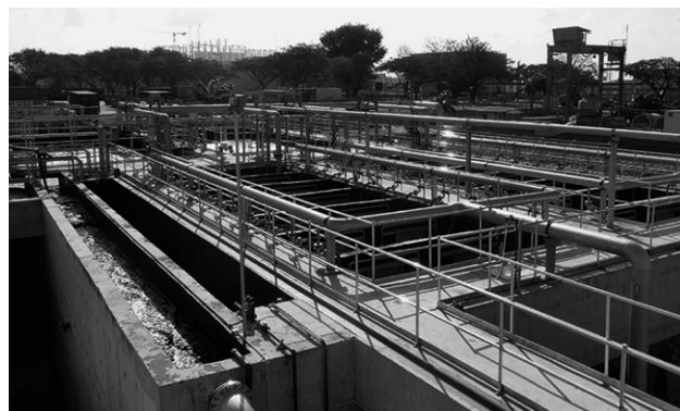
第1図 工業団地集合排水処理設備
