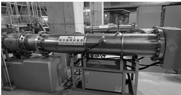
第3図 渡良瀬浄水場の紫外線処理設備
