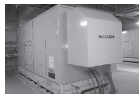
(a) ガス圧縮機
