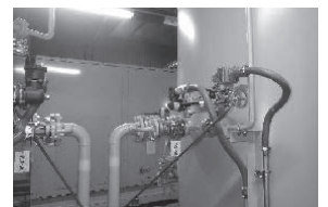
(d) ガス緊急遮断弁
