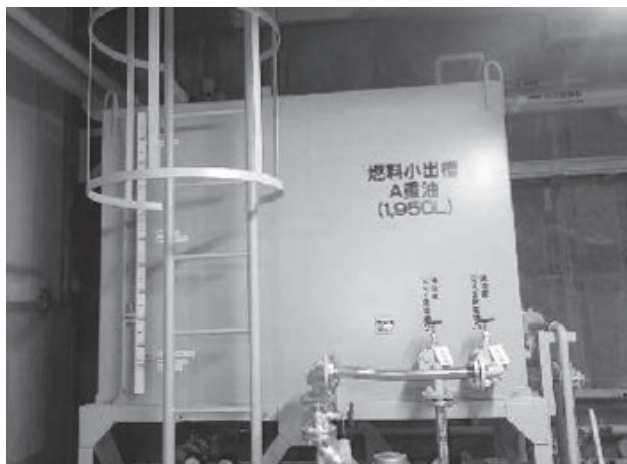
第2図 燃料小出槽
