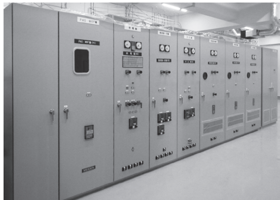
第1図 高圧受変電設備
