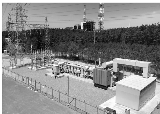
第4図 154kV特高受変電設備
