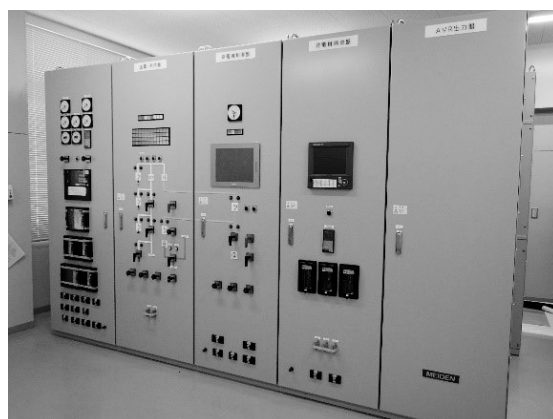
第5図 水力発電設備 (一体形制御装置)
