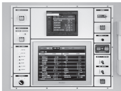
移動電源車 制御盤の操作パネル
