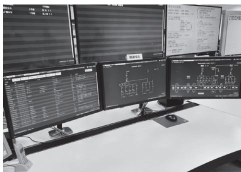
電力管理システム
