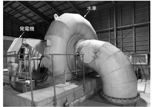
第3図 小屋敷第一発電所 水車発電機
