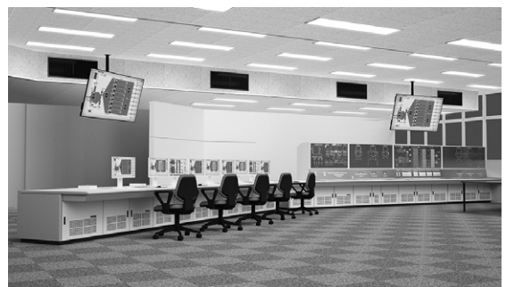
第3図 水処理中央監視装置
