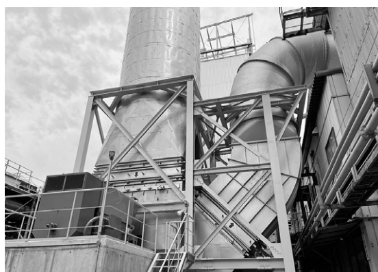
第2図 キルンバグフィルタファンと高圧電動機
