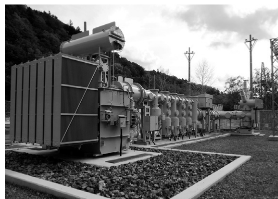
第11図 屋外変電設備(変圧器+V-GIS)
