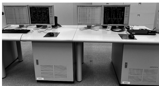
第3図 設備状態監視(保全)システム 監視制御卓
