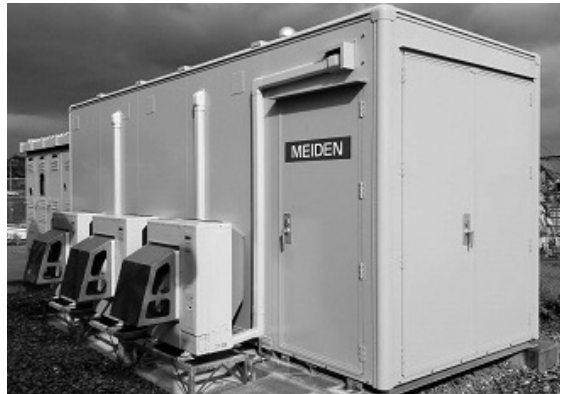
第7図 蓄電池システム
