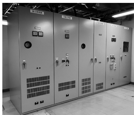
第2図 高圧受配電設備
