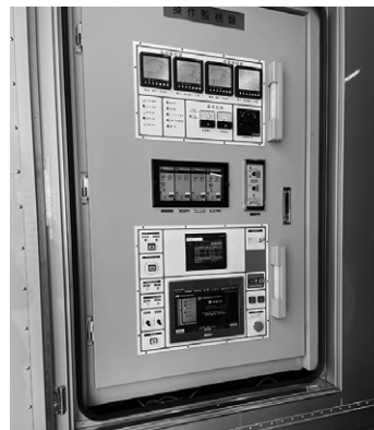
第6図 発電車制御盤面（タッチパネルガイダンス式）
