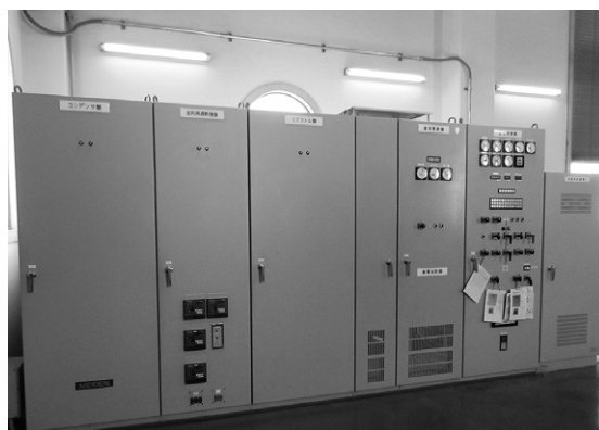
第13図 土師ダム発電制御盤
