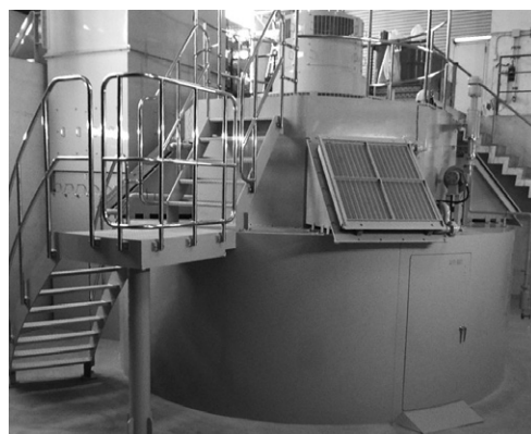
第14図 水力発電設備
