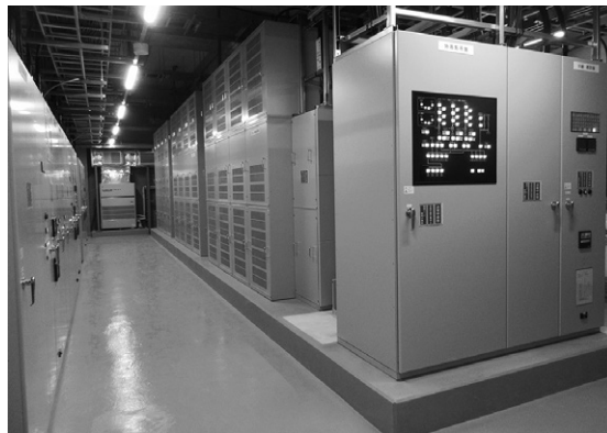
第1図 特高受変電設備
