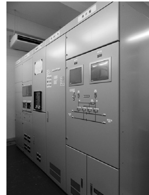
第4図 配電盤設備
