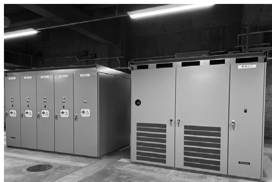
第2図 高圧配電設備・常用OT盤
