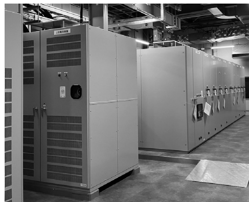
第1図 新山鼻変電所 直流き電設備
