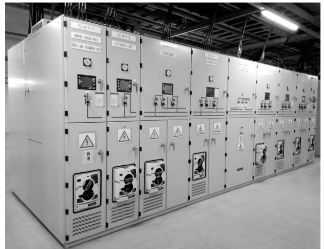
Fig. 9 1500 V DC Switchgear
