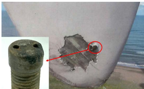
落雷後のレセプタとブレードの損傷例
